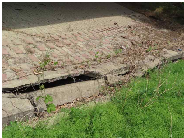
교대 A2 배수로 파손(0.5m×2.0m)
