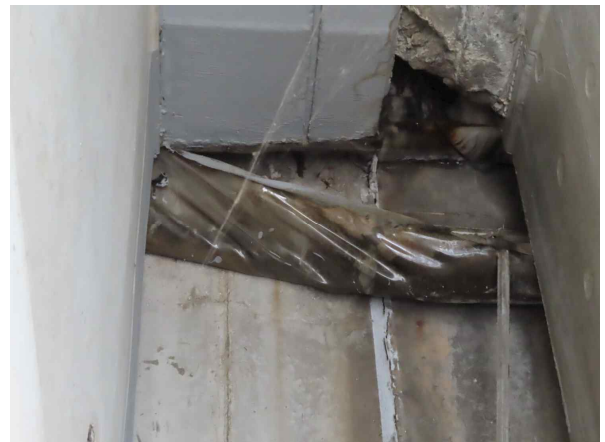
교대 A2 유도 배수시설 탈락(L=1.5m, 2EA)
