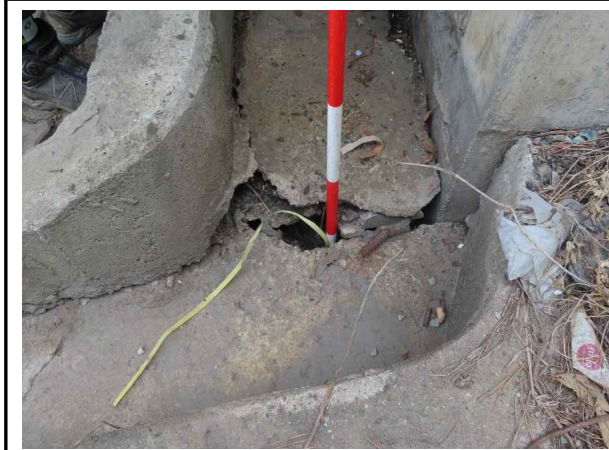
교대 A1 배수로 파손(0.5m×0.5m)
